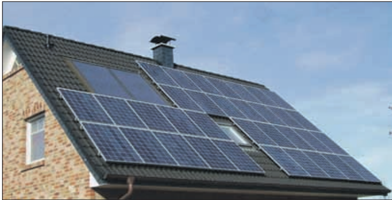
Widok paneli fotowoltaicznych na prywatnych dachach będzie coraz częstszy.
