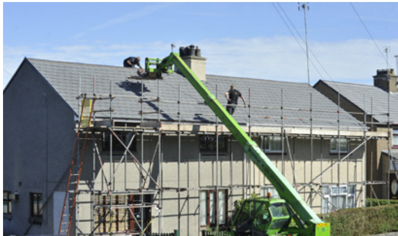
Jeszcze kilka dni na wnioski o środki na usuwanie azbestu. W ramach gminnych programów. Najwyższy czas pozbywać się niebezpiecznego pokrycia dachów i zakładać nowe.
